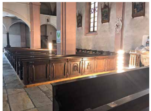
Die Leuchter werden mit LED Lampen bestückt und wieder in die Höhe gezogen.
